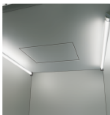
Iluminare cabină cu tehnologie LED.
