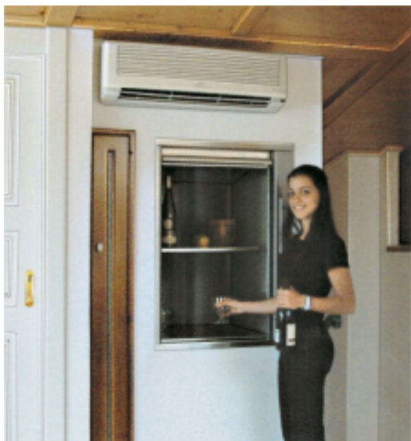
Instalație montată într-o locuință particulară, model 24 kg, având finisaje din inox. Datorită micului ascensor Microlift , transportul cumpărăturilor din garaj în bucatarie nu mai reprezintă o problemă.
