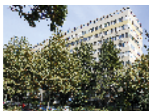
Echipament modernizat: 2 ascensoare electrice, 4 pers., 10 stații Locație: Str. Dezrobirii, nr. 18-38, bl. 33, sect. 2, sect. 6, București Client: ASOCIAȚIE PROPRIETARI
