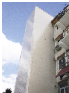
Echipament instalat: Ascensor hidrolic, 18 pers., 5 stații Locație: Str. Jiului, nr. 131, sect. 1, București Client: ARCA HEALTH SERVICES
